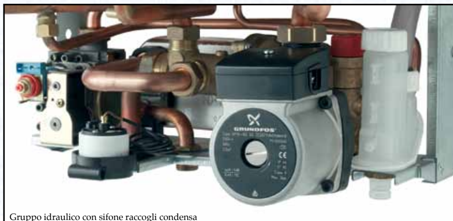
Gruppo idraulico con sifone raccogli condensa
